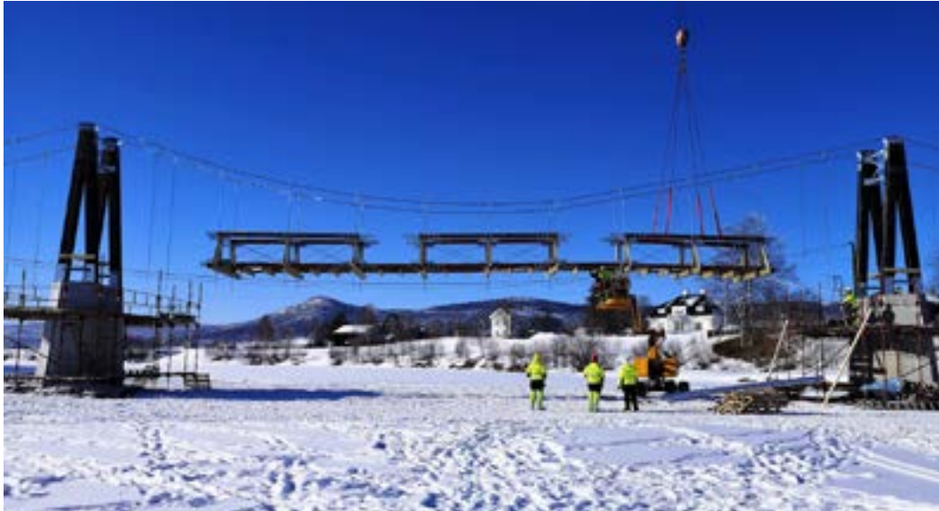
I løpet av noen få uker i mars 2020 ble hele brua reist på isen. Her blir en av de to balkongene montert. (Foto: Ola Grønn-Hagen)
