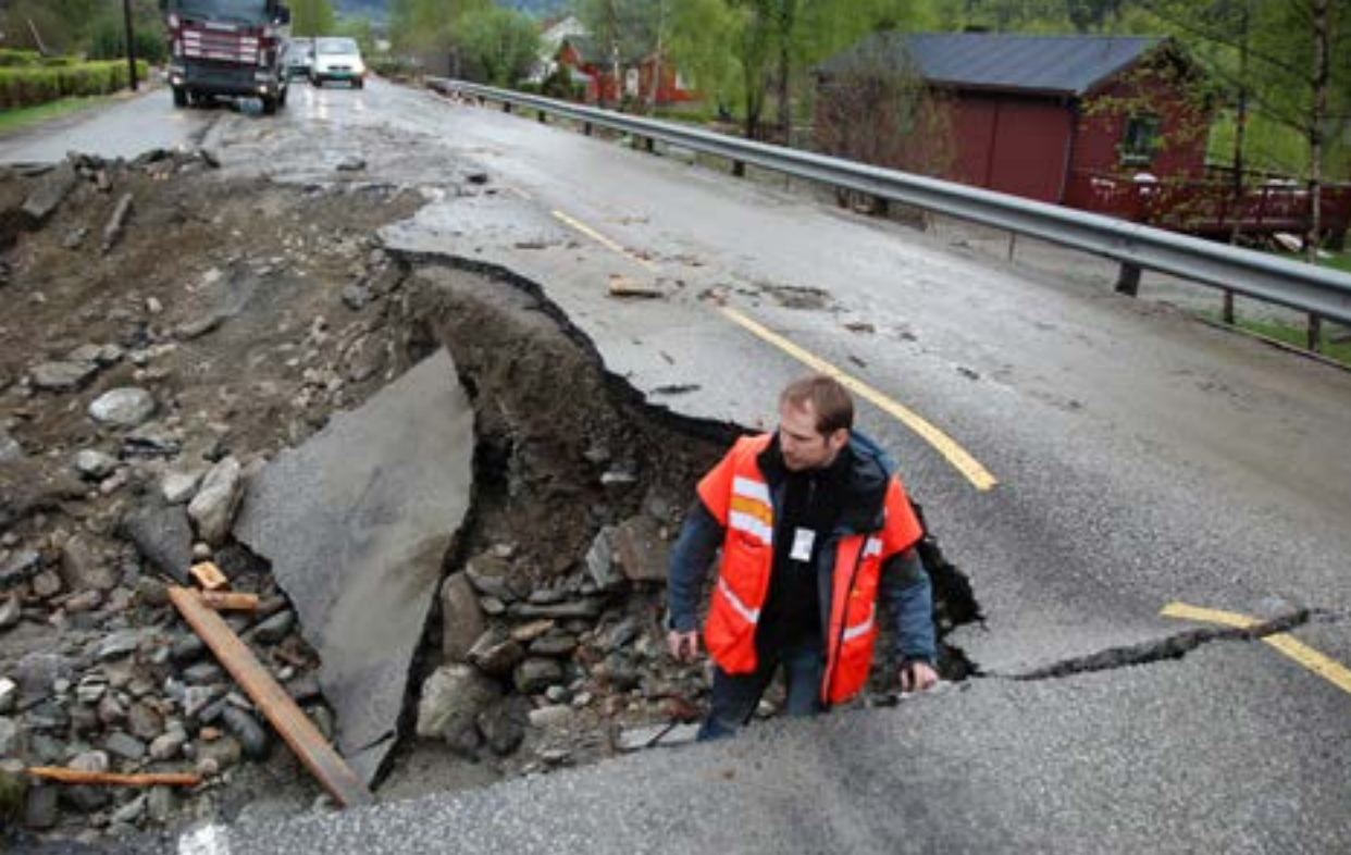
Kvam sentrum ble hardt rammet av flomelva Veiklåa i mai 2013. E6 ble stengt i flere dager da elva gravde bort vegen inntil brua. Senioringeniør Anders Brenne kunne heldigvis slå fast at selve brua var ikke skadet. Senere er E6 flyttet ut av Kvam sentrum. (Foto: Steinar Svendsbakken)
