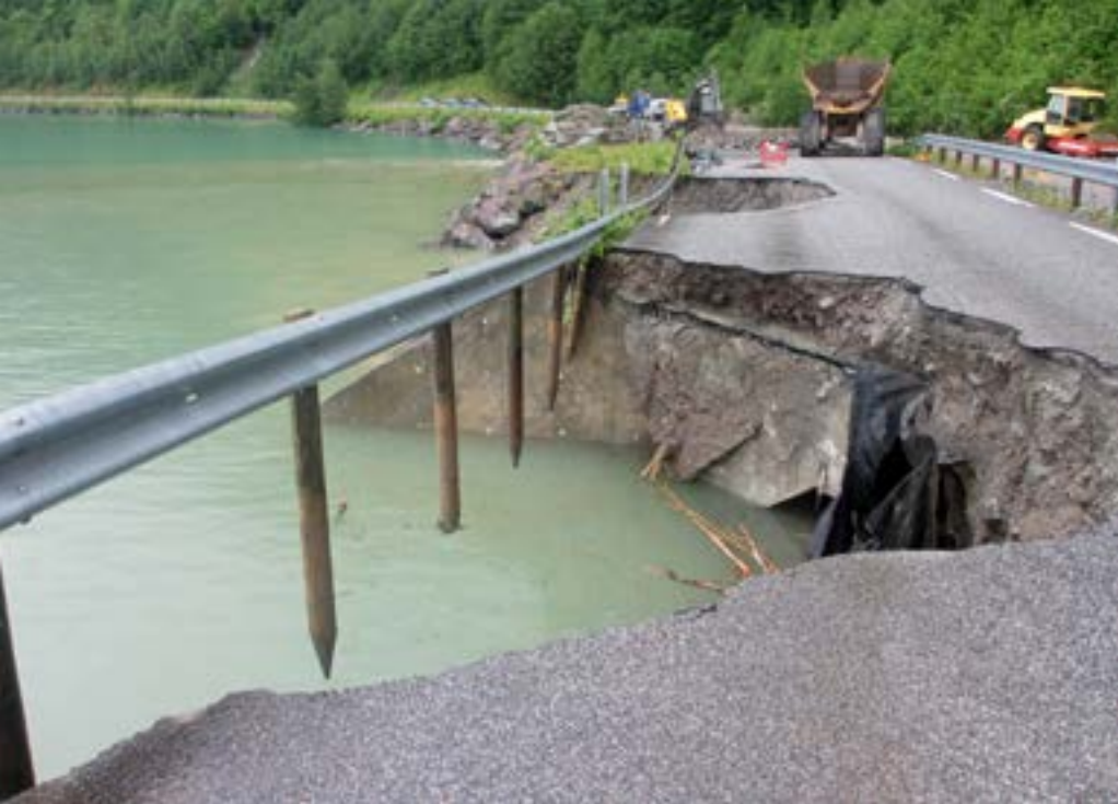
13. juli 2014 gikk det 8 små og store jordskred i Eikesdalen etter store nedbørmengder. Det ene skredet tettet ei stikkrenne og førte til at vegen ble vasket ut. Organisasjonen reagerte. Veger ble stengt, arbeidet med å gjenopprette trafikkforbindelsene startet opp umiddelbart og etatens informasjonsarbeid ble håndtert i linja. (Foto: Anne Marit Øksenvåg Johansen)
