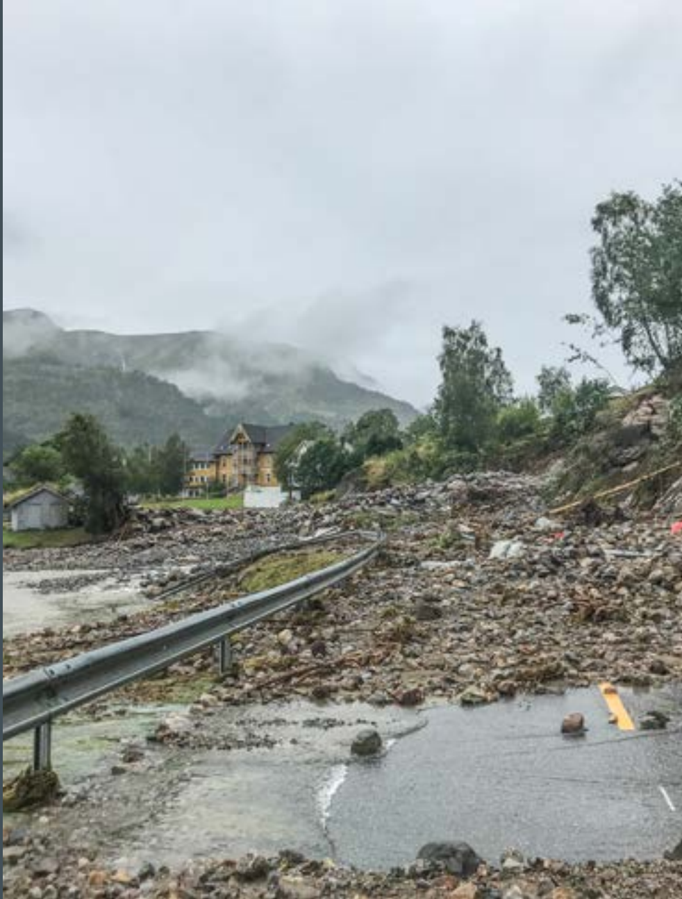
E39 ved nordsiden av Jølstravatnet ble rammet av fire ras over en strekning på tre kilometer under storflommen 30. juli 2019. Det tok to uker før vegen var åpen igjen. (Foto: Silje Drevdal)
