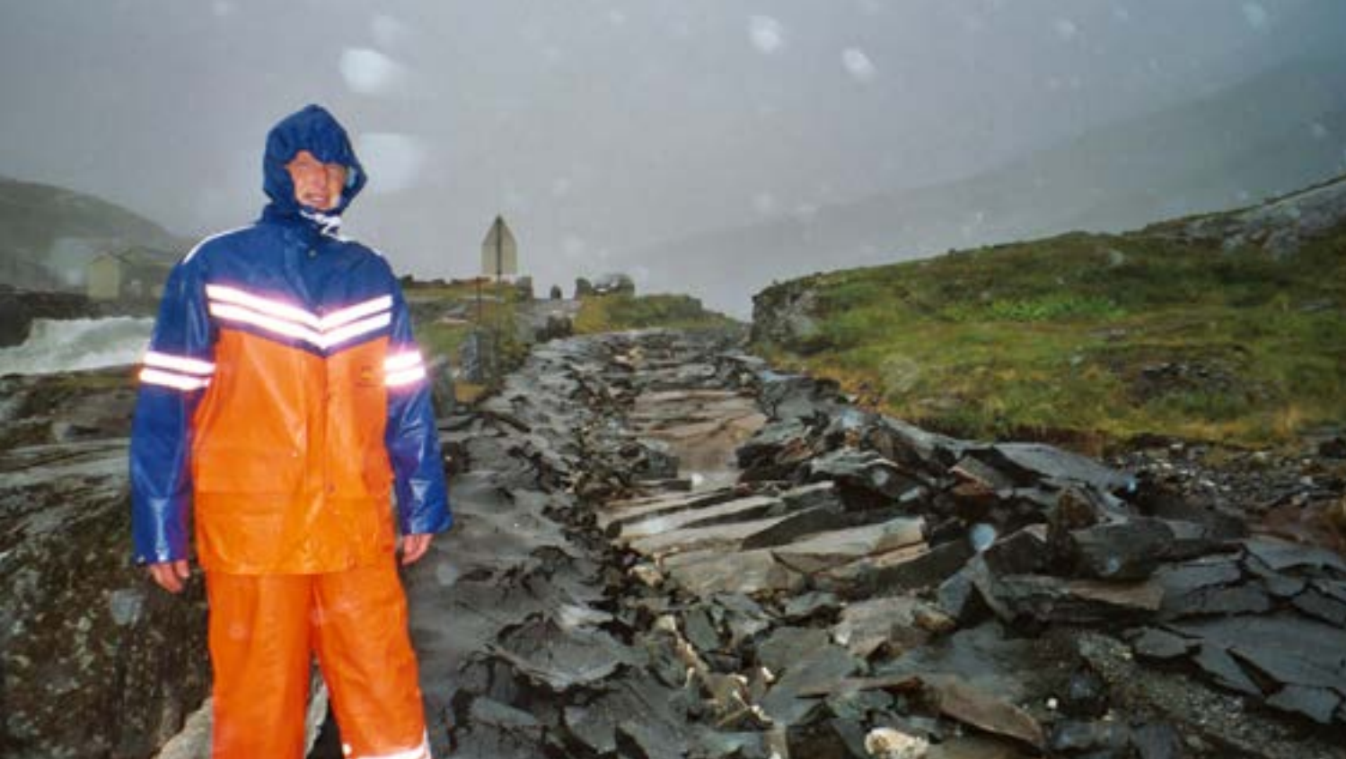
Distriktssjef Jan Arild Johansen på Trollstigen august 2003. Kraftig regn hadde omgjort vegen til flomveg, noe den ikke var dimensjonert for. (Foto: Elisabeth Schjølberg)
