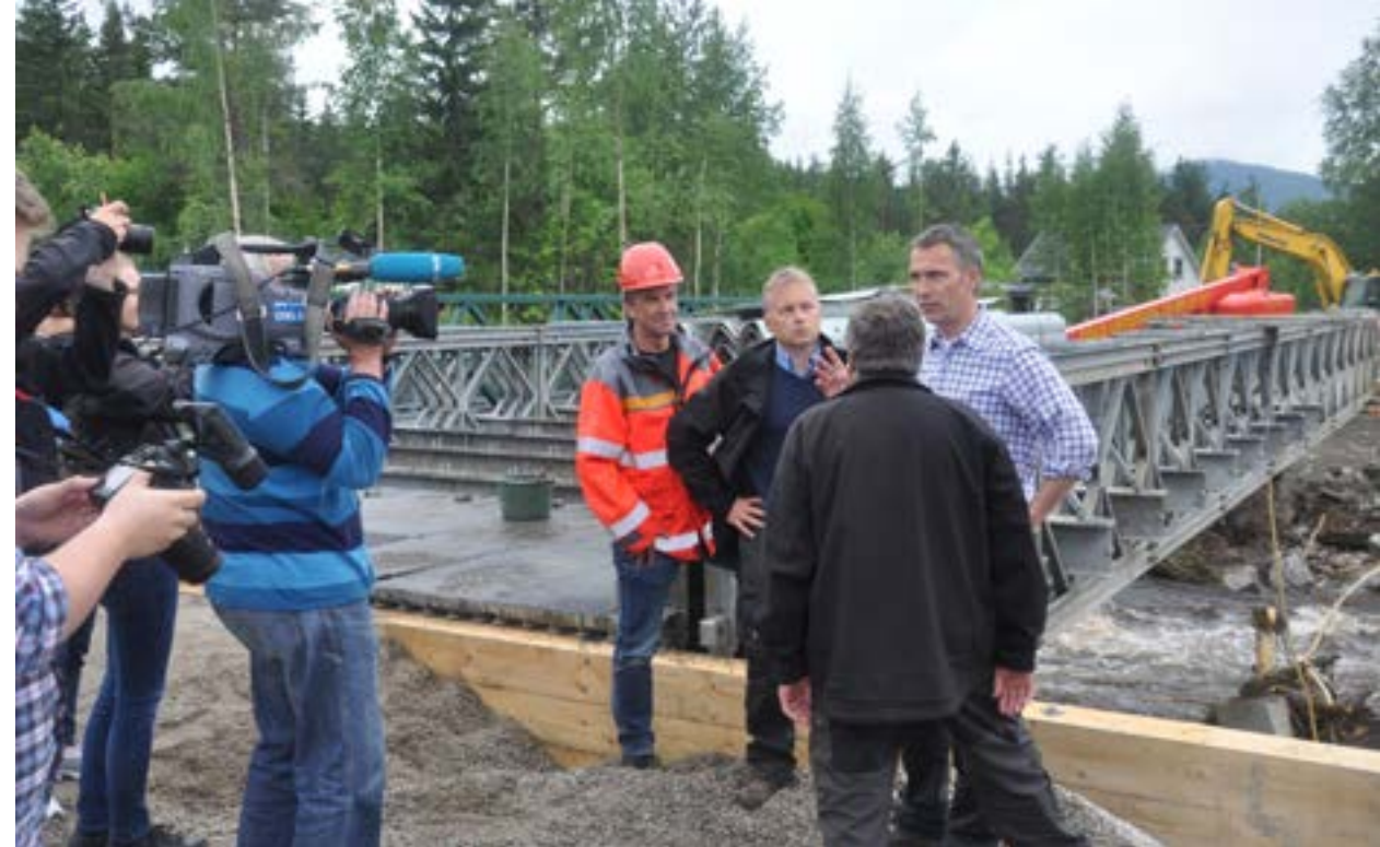
Daværende statsminister Jens Stoltenberg og justisminister Knut Storberget fikk et godt inntrykk av reservebruberedskapens betydning da en rv3-bru syd for Koppang i Østerdalen ble tatt av flom 11. juni 2011. Dagen etter kom de til stedet og studerte monteringen av en reservebru sammen med bl.a. Vegvesenets driftsleder Per Magnar Klomstad. (Foto: Håkon Aurlien)
