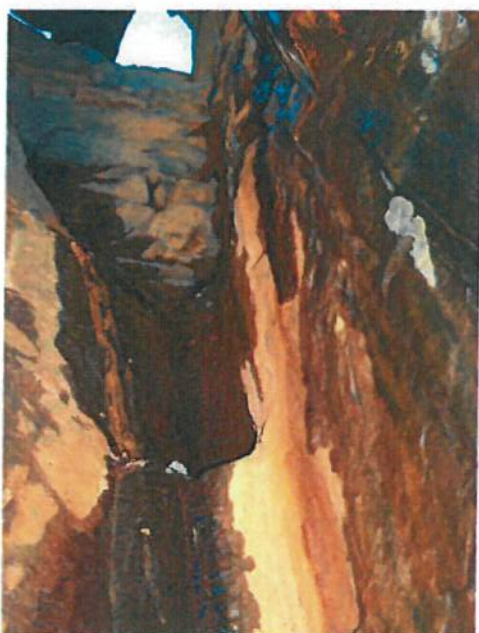
Bilde over, Skram A: (Det øverste på bildet) Skrambredde: 0,23[m] Skramhøyde: 1,2[m] Plassering: Bunn av skram, 7,8 høydemeter under starten av etappe. Over skrammet kan en se tydelig steinsetting av sjaktens vestside opp mot dagen. Antar at dette partiet er på ca 2 [m]
