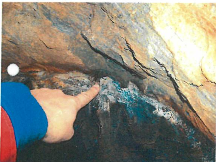
Øverst på kilsumpen, ved stoll-taket, har noe av treverket en hvitaktig farge. Det kunne med en gang virke som om det var en slags muggsopp, men dette ble avvist ved nærmere pirkeprøver. Treværket hadde akkurat samme kvalitet som resten av veggen. For oss kan det se ut som om det kan være en slags utfelling av kalk fra den kalkspatåra som går i stolltaket i dette området.
