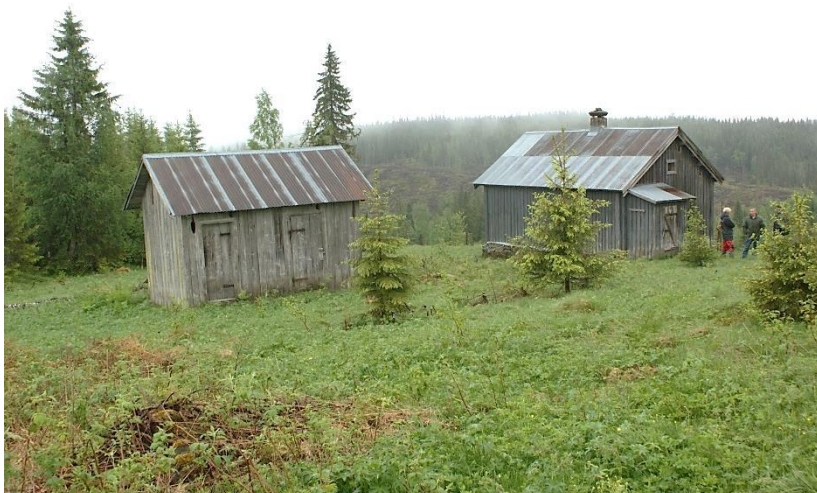
Et gedigent spleiselag: Bjønnhaughytta i Snertingdal, en tidligere husmannsplass som hjemmestyrene disponerte under krigen, sikres og settes i stand med tilskudd fra Norsk Kulturminnefond, Stiftelsen UNI, Norsk Arbeidsmannsforbund, Oppland fylkeskommune og Gjøvik kommune.
