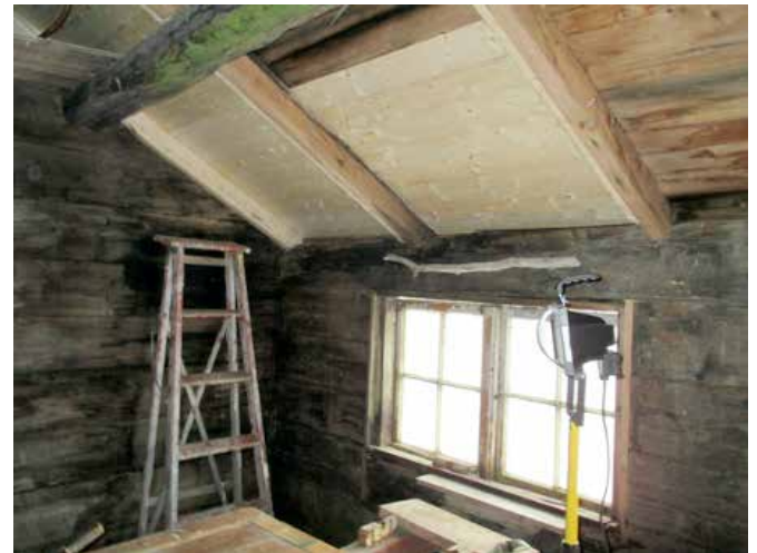
Deler av troa var svært råteskadet. Reparasjon i forbindelse med taksikring
