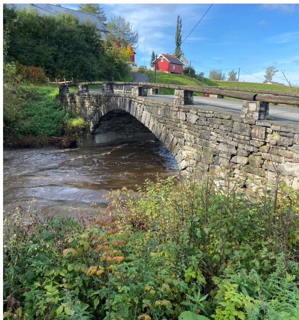
Håjen bru i Østre Toten, Innlandet, en steinhvelvbru fra 1861 der kommunen nå jobber med å sette opp skilt og skifte rekkverk. Vi er inne som rådgivere. (Foto: Cathrine Thorstensen)
