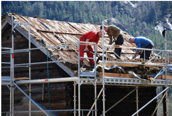
Det er ikkje tilfredsstillande at taket er tett dersom det ligg grunnmurplast under torva. På Guggedalsloftet blei grunnmurplasten erstatta av never sommaren 2010. Løysinga med takpapp og grunnmurplast var i si tid føreskrive av Riksantikvaren.
