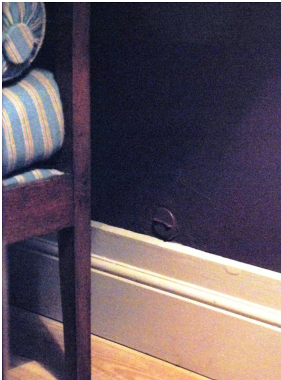
Diskret plassert fuktigheitsmålar i ein av veggane på Ledaal. (Sjå det runde lokket rett over golvlista.)
