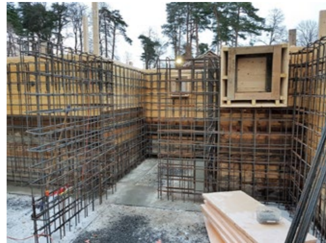
Da Ole Andreas Persen bygde seg hus i Olderfjord hadde han ikke tilgang til armeringsjern. Det førte til setningsskader og sprekker i grunnmuren. På Norsk Folkemuseum risikerer vi ikke det.
