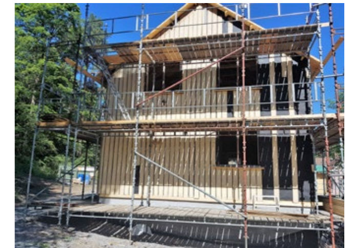
Bolighuset hadde utvendig lektepanel. Vi har for det meste gjenbrukt underliggerne, mens overliggerne i noe større grad ble ødelagt under demontering. Foto: Espen Revold, Norsk Folkemuseum.
