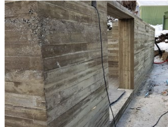
Grunnmuren er støpt med moderne metoder. Vi har imidlertid prøvd å skape en overflate som ligner mest mulig på den opprinnelige muren. Dette kan man kalle visuell autentisitet.
