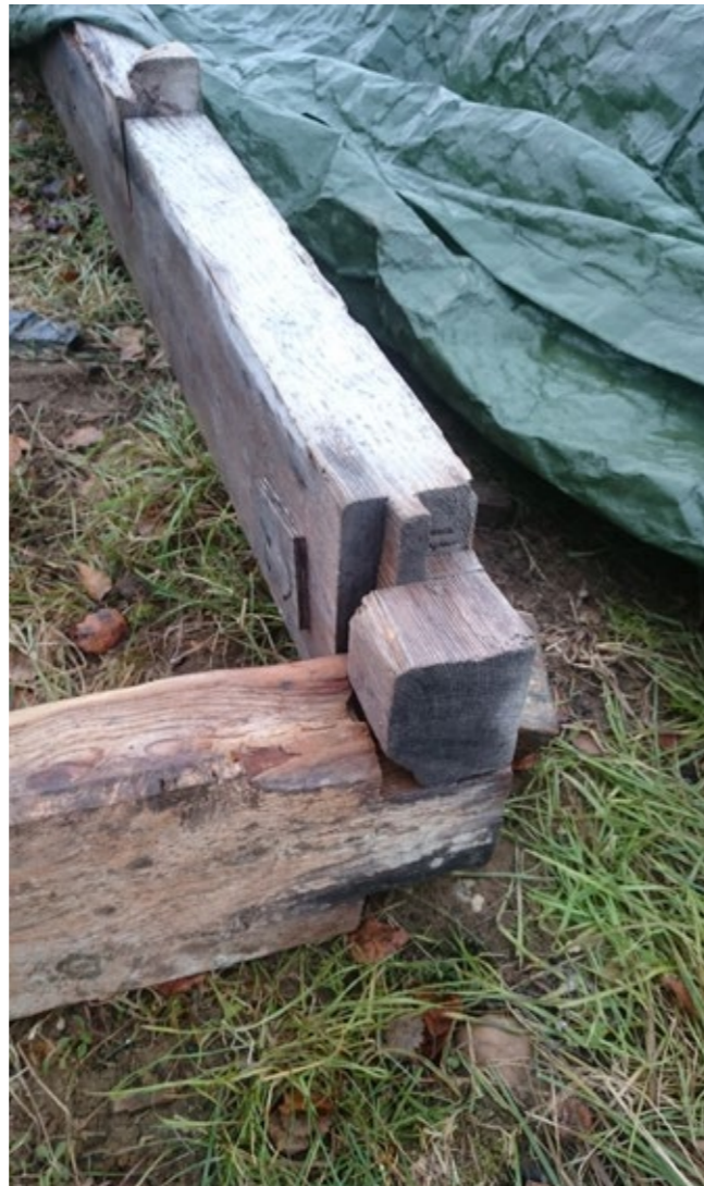
Eksempel på tapplaft fra en bygning i Børselv oppført før krigen. Det finnes eksempler på dette laftet i bygninger tilbake på 1700-tallet i Troms og Finnmark. Foto: Arnfinn Kaaby.
