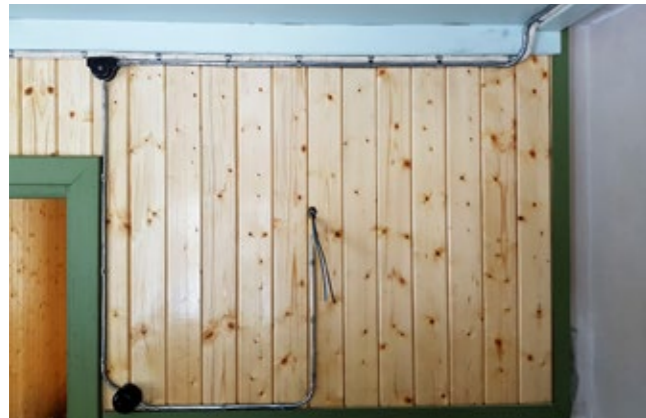
Historisk kulokabel og blykabel er på plass mens den funksjonelle elektriske tilførselen til et lampepunkt på kjøkkenet kommer fra et skjult anlegg. Foto: Espen Revold, Norsk Folkemuseum.
