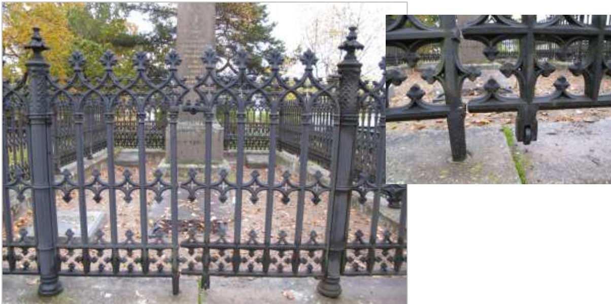
Staket, troligtvis från 1890-tal. Det rullande hjulet är till för att avlasta grindens tyngd och på så vis upprätthålla grindens funktion under lång tid. Här har sockeln sjunkit och hjulet har tappat sin funktion.
