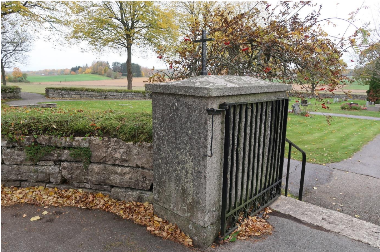
Västra kyrkogårdens huvudentré med djupa grindstolpar av granit krönta med överliggare och kors. Grindstolparna har en krysshämrad yta och korsen en hämrad yta.
