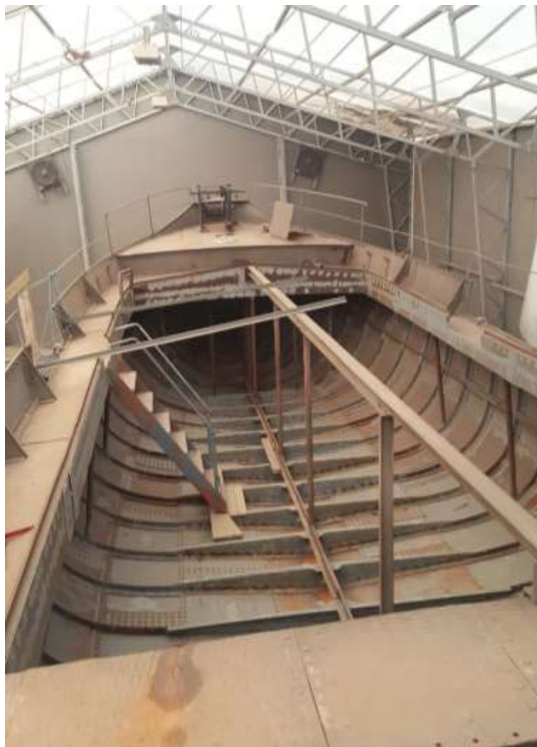
Stålarbeid BB ved maskinskott ferdigstilt opp til F-gang. Gjenstår arbeid på Plate F spt 6-10 og F spt 10-13
