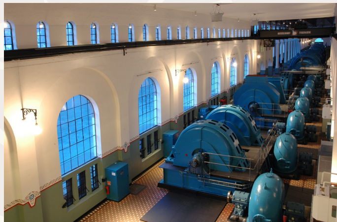
Den 180 meter lange maskinsalen med 15 aggregat. Den gamle traverskranen er godkjend og framleis i bruk. Foto: Harald Hognerud, NVIM
