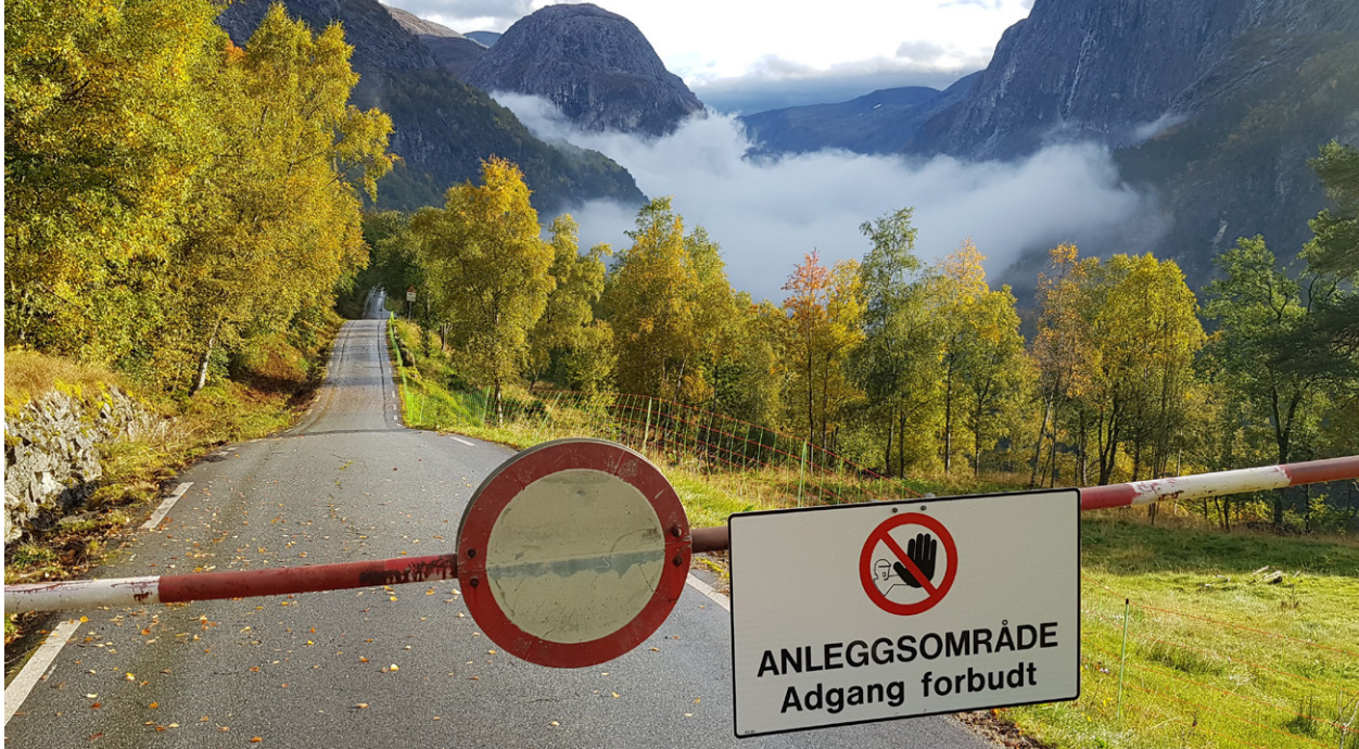
Vegen vart stengd i 2021 då det viste seg at skadane på yttermuren i Minesvingen var omfattande. (Foto: Ann Kristin Engh)
